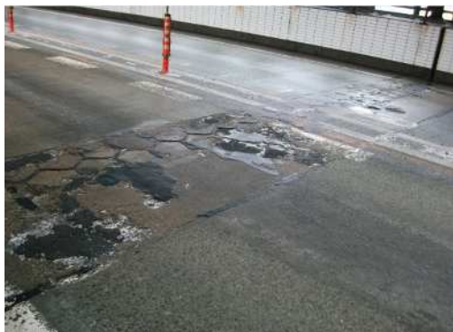
【伸縮装置の経年劣化状況】
