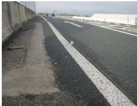
【舗装の損傷状況】
