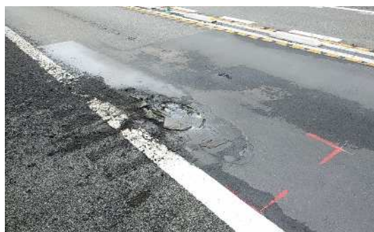
【損傷箇所①】
