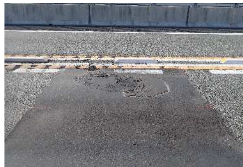
【損傷箇所②】
