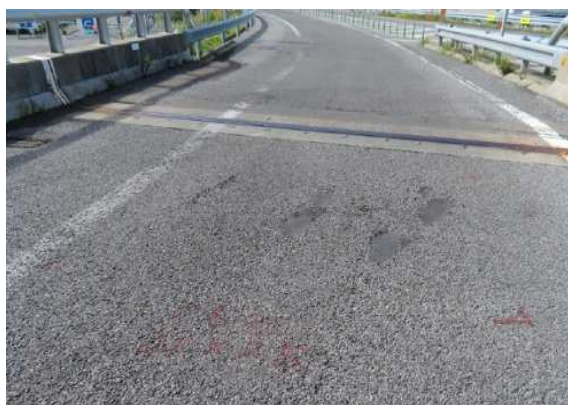
【路面損傷状況】
