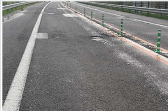
【路面損傷状況】
