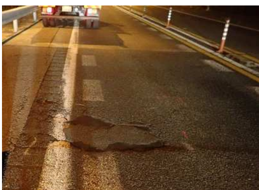
【路面損傷状況】
