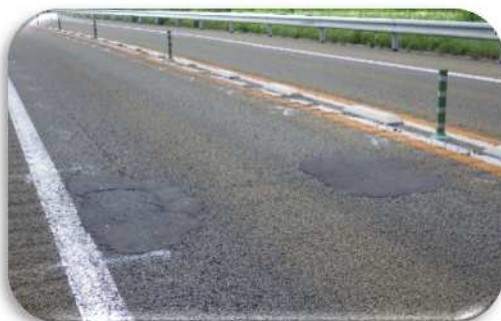
舗装損傷状況
