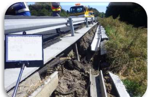
のり面損傷状況
