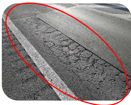
舗装損傷状況
