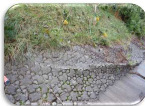
のり面損傷状況
