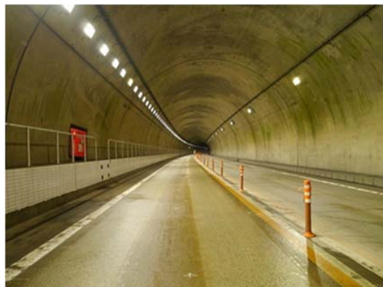
<トンネル内照明状況>
