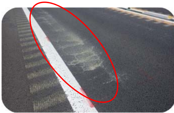
舗装損傷状況
