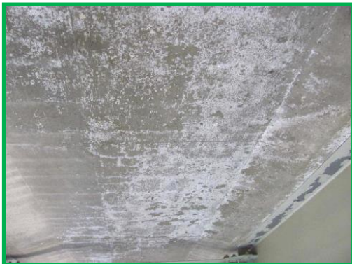
【コンクリート床版裏面のひび割れ状況(小仁熊橋)】
