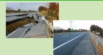
東日本大震災で被災した高速道路(常磐道)
